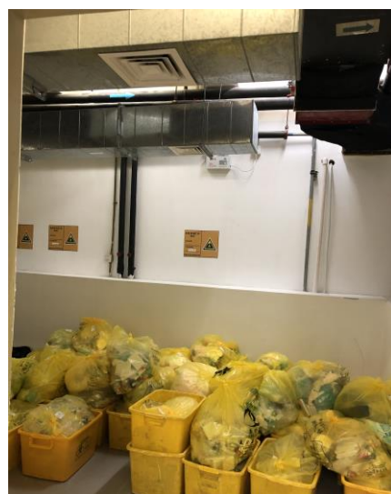
应急通风及安全照明
