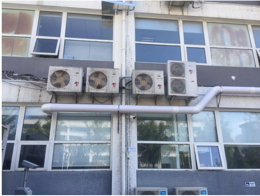
图 4-5 扩建项目排风管道
