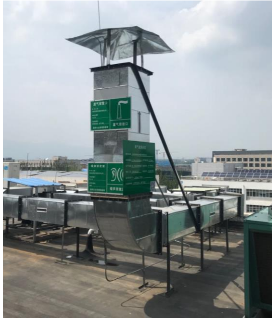
图 4-12 本项目排口标识牌
