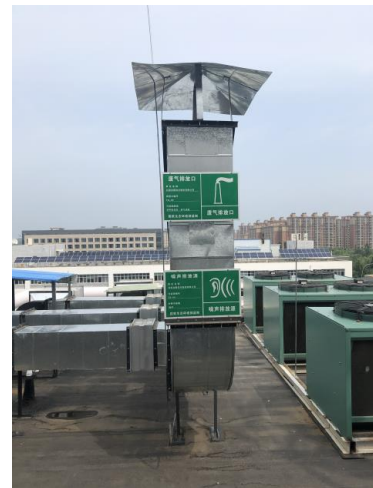
扩建项目排气筒
